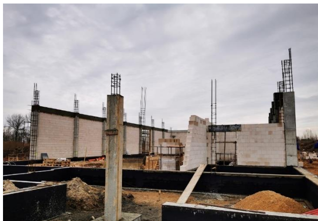
Obiekt Centrum Zarządzania Komunalnego i Kryzysowego w m. Szczuczyn w trakcie budowy
